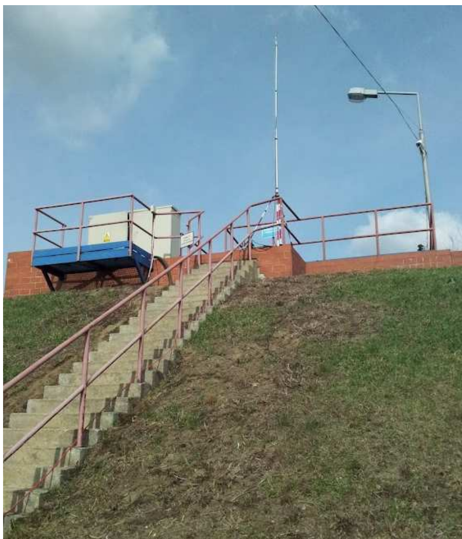
Zdjęcia pokazujące anteny dookólną zamontowaną na maszcie 5m na osadniku.
